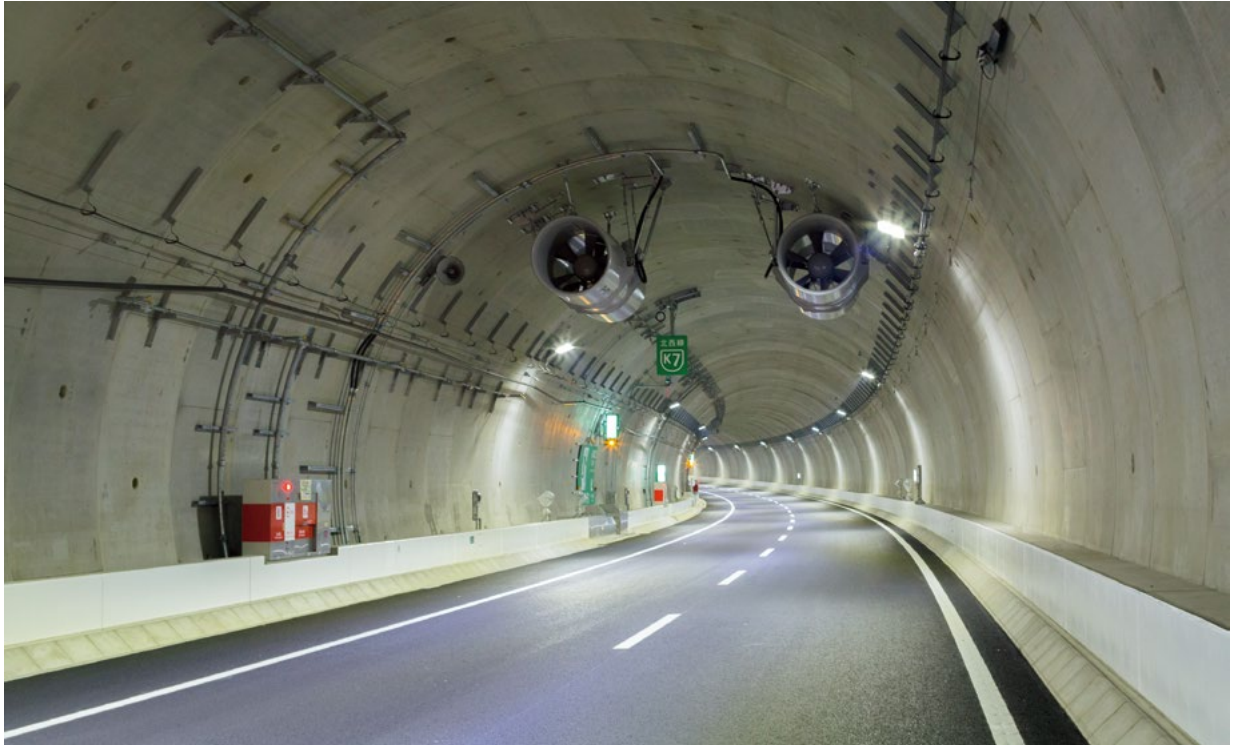
高速横浜環状北西線シールドトンネル建設工事(道路) 外径φ12,400mm×厚さ450mm×幅2,000mm 神奈川県
